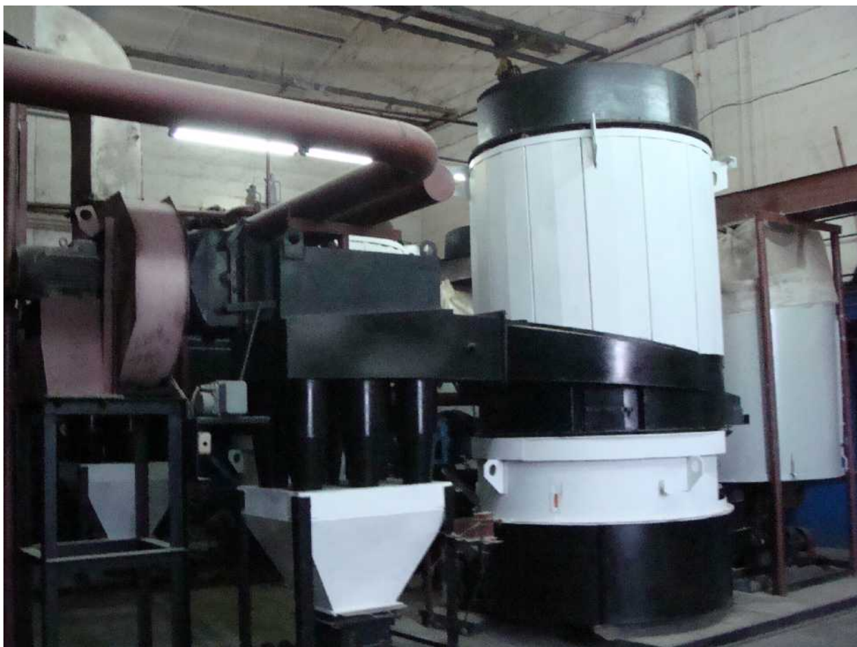
Рис. 3.3.2.1. Отопительный котел по сжиганию опила
